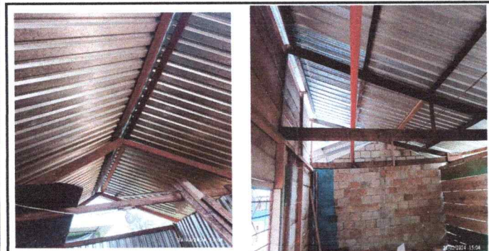
Foto 3: Se puede Observar la estructura de costaneras que se encuentra en mal estado y la falta del sistema electrico en el modulo 1
