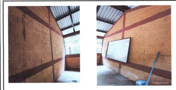
Foto 5: Se puede observar la falta de mantenimiento en la pintura de las aulas en el modulo 2
