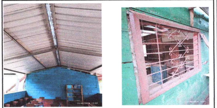
Foto 2: Se observa en el area de ventanería, piezas en mal estado y/o faltante en el modulo 1
